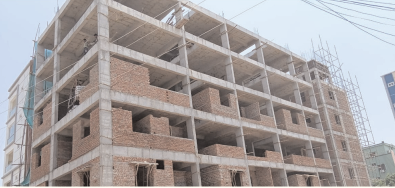
రాఘవేంద్ర కాలనీలో అక్రమ నిర్మాణం
